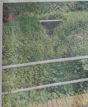
Durch ein Rohr wird der Stingesbach unter der Bahnstrecke hindurchgeführt. Vor und hinter dem Damm kam es (noch) zu keiner Seenbildung.
